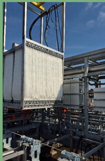
Figura 1 – Cassetta ZeeLung durante l'installazione nella vasca anossica
